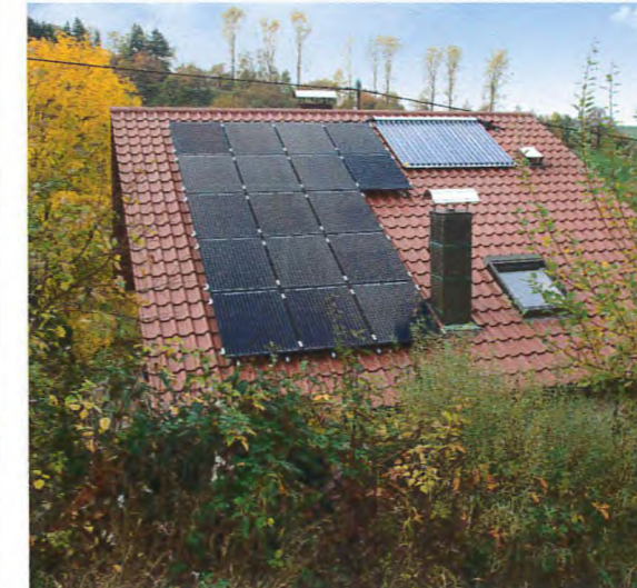
Verschwindend klein wirkt der Hochleistungssolarkollektor gegen die Photovoltaik-Module.
