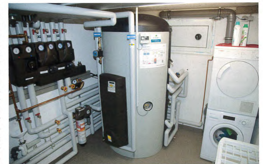
Moderne energiesparende Technik benötigt nicht mehr viel Platz – im Technikraum ließen sich auch noch problemlos Haushaltsgeräte wie Waschmaschine und Wäschetrockner unterbringen.
