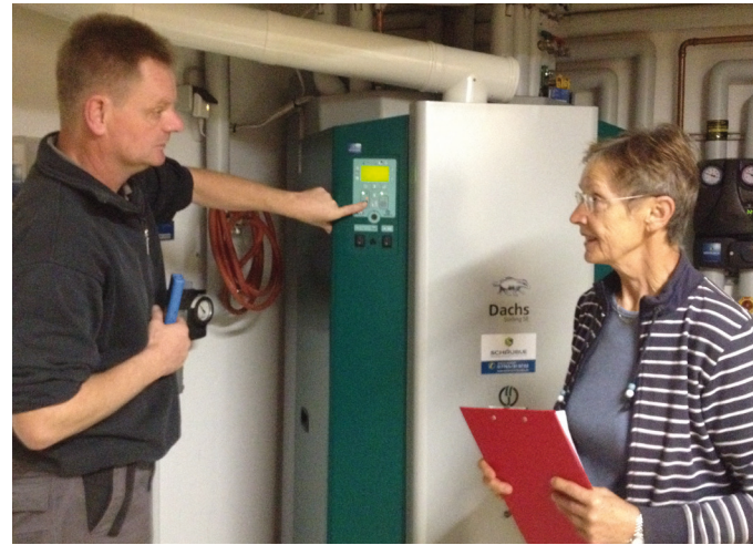
Energiewende in den eigenen vier Wänden – Servicetechniker Gerhard Strittmatter erklärt einer Kundin die Funktionsweise des Dachs Stirling.
