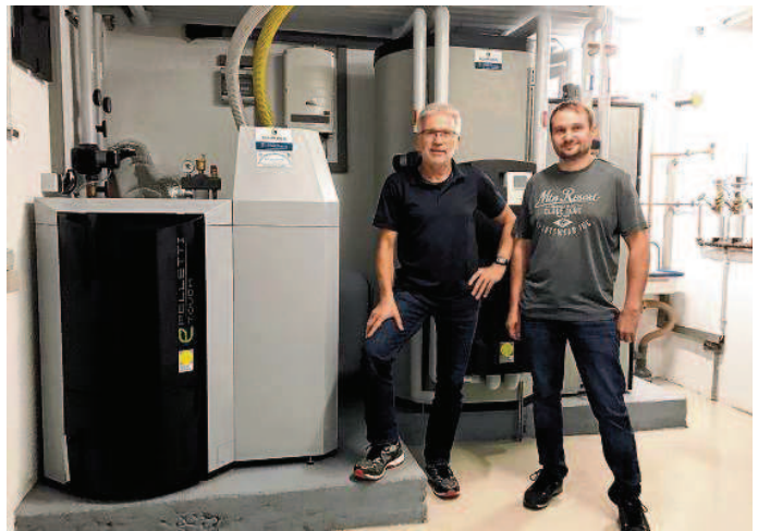
Franz Ebner und Sohn Tobias aus Schönenbach nutzen den regionalen Rohstoff Holz zur Energiegewinnung. Im Bild mit ihrer neuen Pelletsanlage, der Paradigma Pelletti Touch. BILDER: SCHÄUBLE - REGENERATIVE ENERGIESYSTEME
