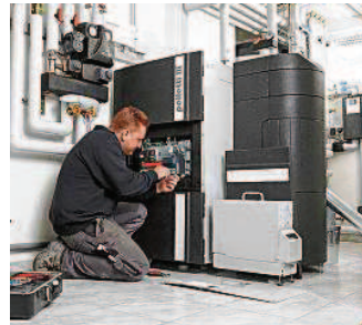
Durch eine Modernisierung der Heizung liegen bis zu 45 Prozent Förderung drin. BILD: SCHÄUBLE - REGENERATIVE ENERGIESYSTEME, RICKENBACH/HOTTINGEN.
